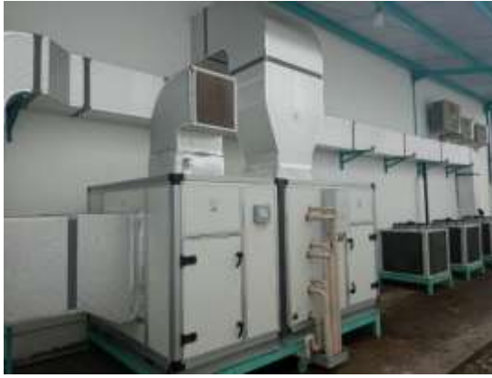
Gambar 4.2 Air Handling Unit PT Jayamas Medica Industri Sumber : Dokumen Pribadi PT Sampoerna Tritunggal Pratama
