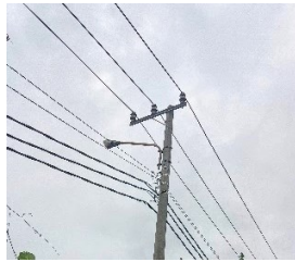
Gambar 4. 20 Jaringan Listrik Sumber : Observasi Lapangan, 2025
