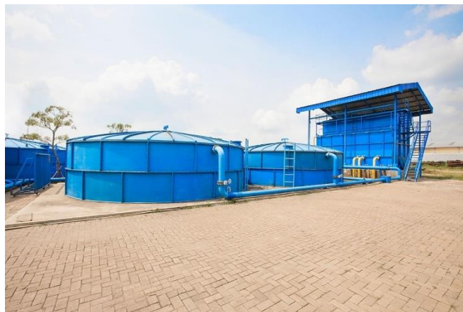
Gambar 1.1 Instalasi Pengelolaan air PT XYZ
