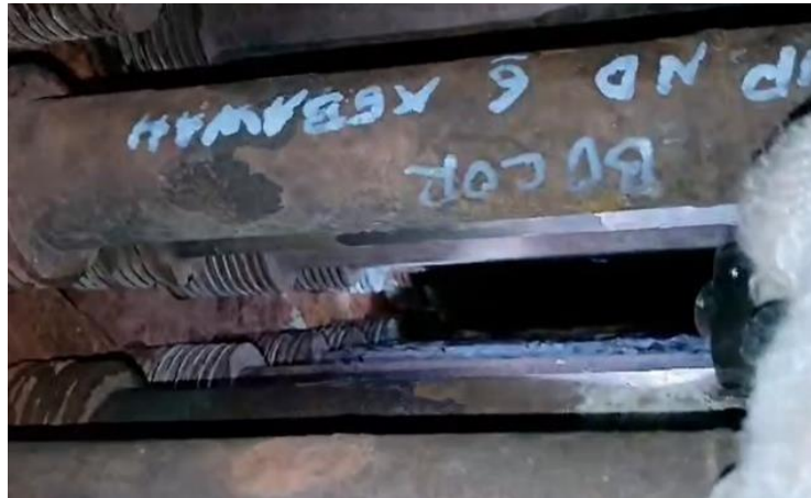
Gambar 4. 40 Kondisi Tube HRSG Bocor
