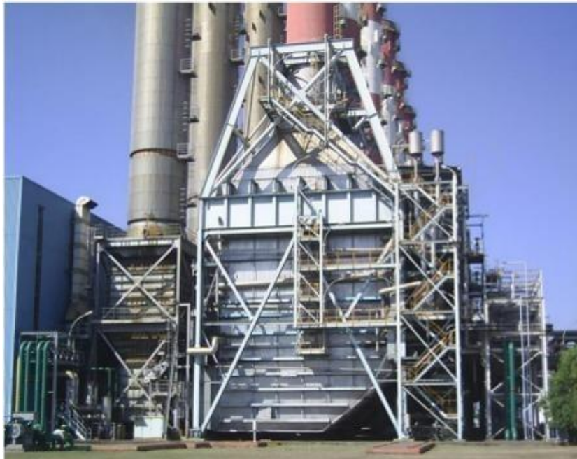
Gambar 4. 11 HRSG (Heat Recovery Steam Generator)
