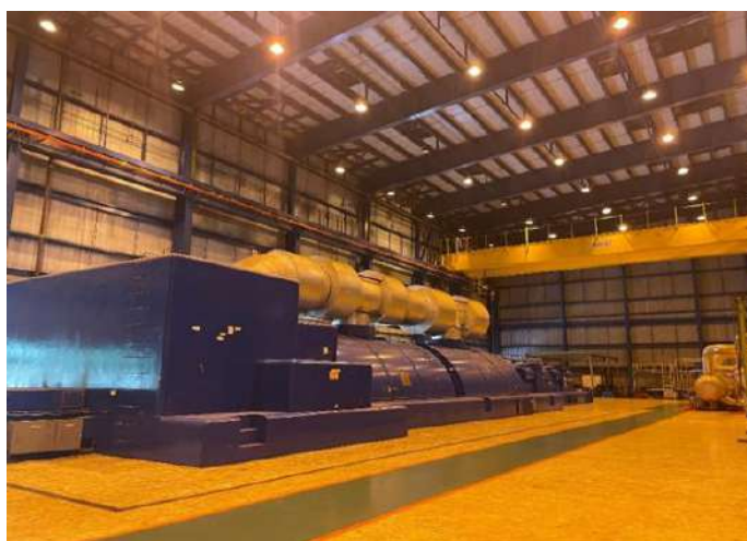
Gambar 4. 3 Turbin PLTU Paiton
