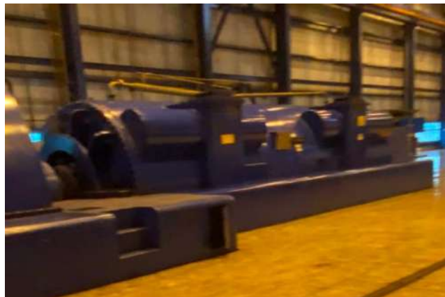
Gambar 4. 4 Generator PLTU Paiton
