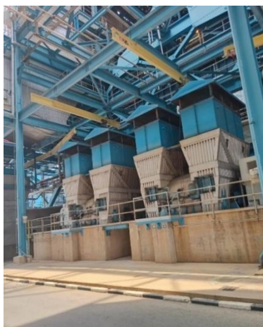
Gambar 4. 7 Primary Air Fan
