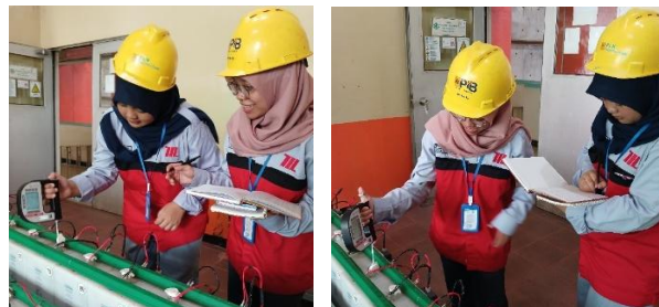
Gambar 4.22 Pengambilan Data Baterai dengan Density Meter
