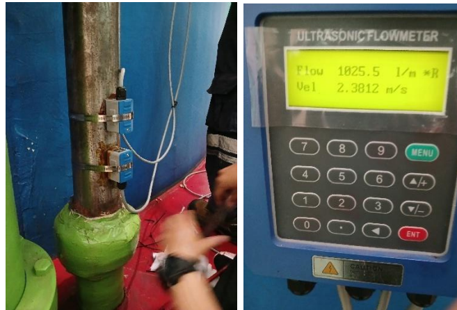
Gambar 4.29 Sensor Ultrasonic Flow Meter yang sudah Terpasang (Sumber: Dokumen Penulis, 2025)
