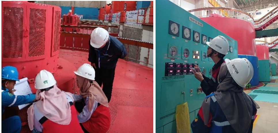
Gambar 4.21 Pemantauan Parameter Kerja Generator (Kiri) dan Turbin (Kanan)
