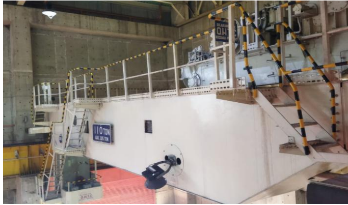
Gambar 4.13 OverHEAD Travelling Crane (OHTC) (Sumber: Dokumen Penulis, 2025)
