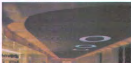
Foto 4.7.1 Ceiling dengan up ceiling
