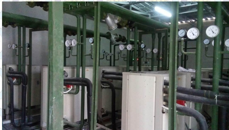
Gambar 4.21 Tampak dalam ruang control sistem pendingin terminal GSN.
