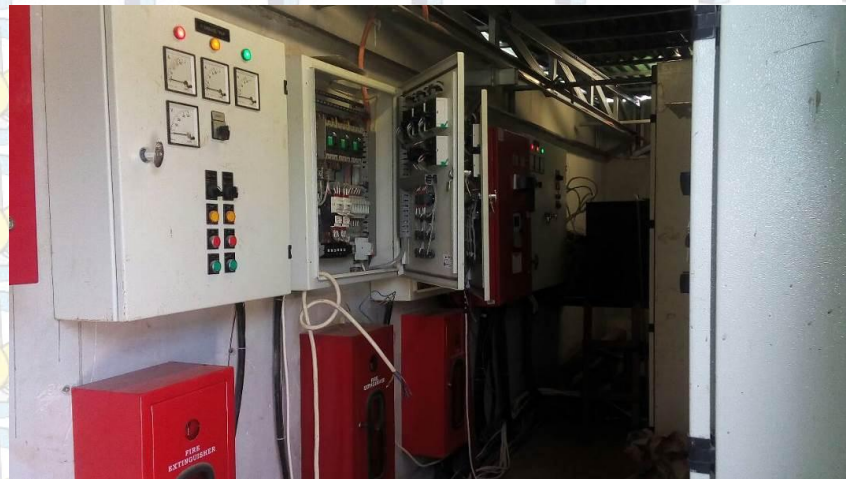
Gambar 4.23 Tampak dalam Sewage Treatment Plant yang merupakan ruang control STP tersebut.
