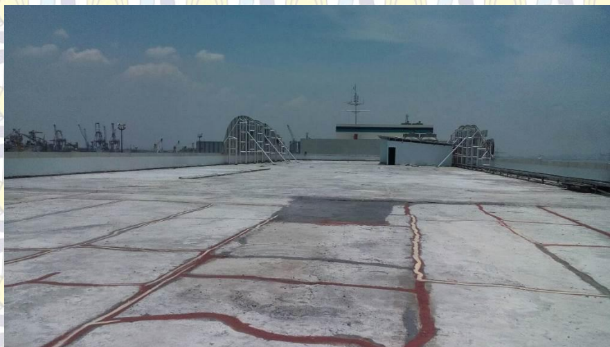
Gambar 4.25 Bagian atas terminal GSN yang rencananya akan digunakan untuk sumber tenaga alternatif yang menggunakan solar cell .
