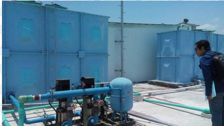
Gambar 4.20 Sistem pendingin milik terminal GSN yang menggunakan VRF.
