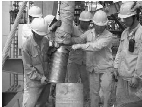
Gambar 2.41 Detail pengangkutan kabel pada dek jembatan Suramadu ( www.wiryanto.net )
