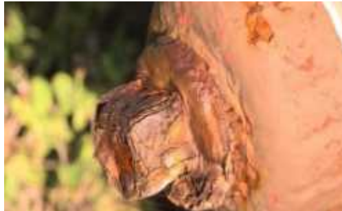
Gambar 2.12 Korosi lelah komponen boiler
