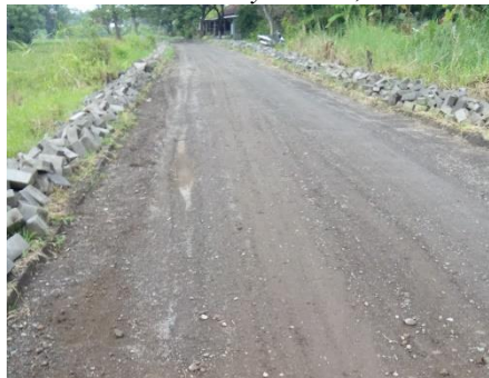
Gambar 4.11 Kondisi jalan tanah di Desa Beton, Kecamatan Menganti
