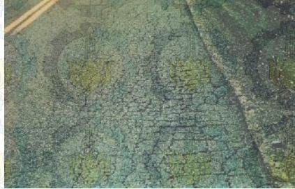
Gambar 2. 2 Retak kulit buaya (alligator cracks)
