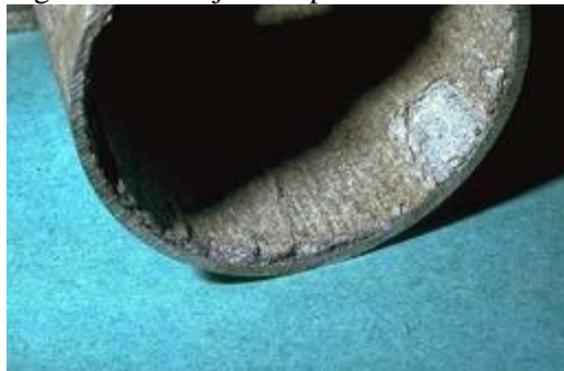
Gambar 2. 7 Korosi Intergranular Pada Pipa ( Scribd.com/korosi )
