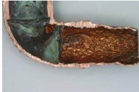
Gambar 2. 11 Korosi Erosi Pada Pipa ( Mechanicalengineering, 2012 )
