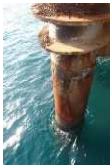
Gambar 1.1 korosi yang terjadi pada jacket leg (PT. PHE ONWJ)
