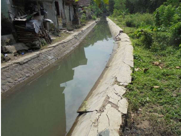
Gambar IV.1. Tampak Talud Saluran yang Rusak
