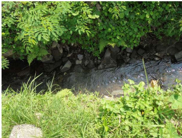
Gambar IV.6. Pasangan batu yang sudah rusak parah
