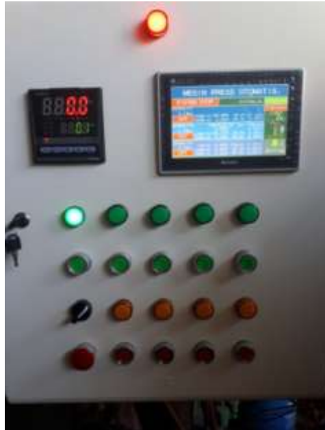
Gambar 3.5. HMI LPS-070 pada control panel
