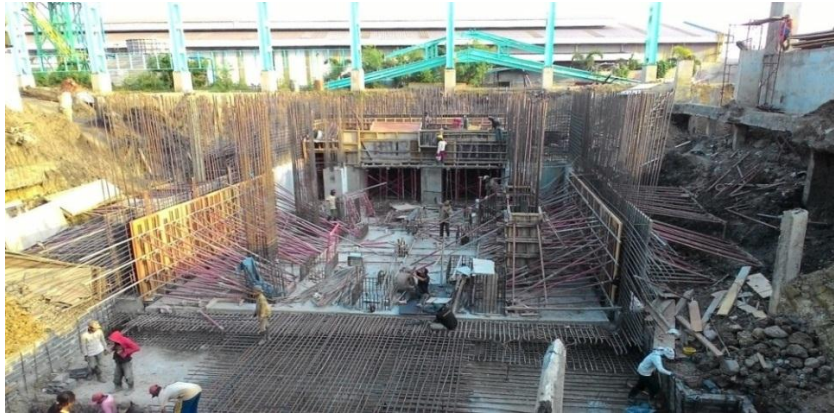
Gambar 4.7 Galian Untuk Pondasi Mesin Dan Kolom Terlalu Dekat
