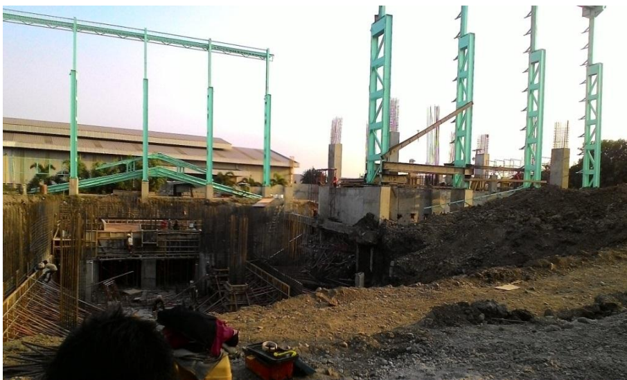
Gambar 4.10 Lokasi longsor di PT Jatim Taman Steel
