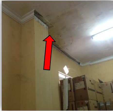
Gambar 4. 20 Kondisi Atap Ruang Penyimpanan (a) SMA Negeri 1
