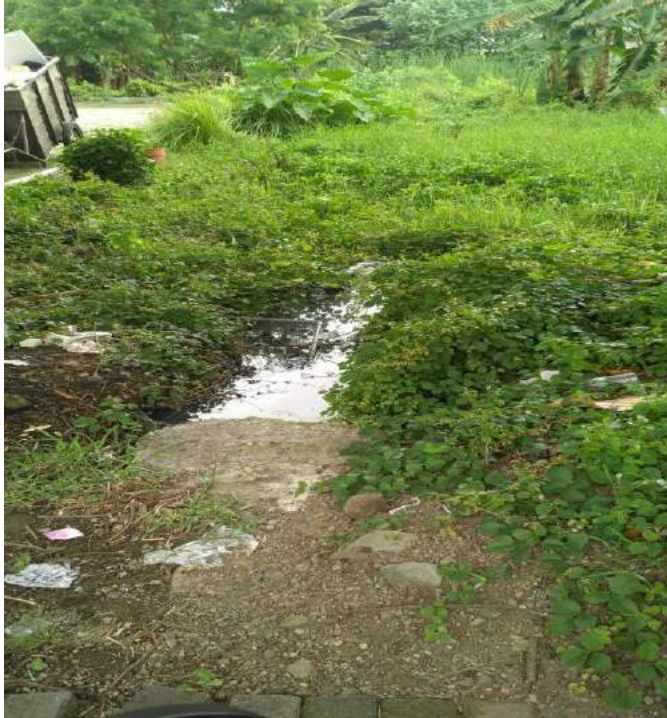
Gambar 0-1 Saluran Eksisting Perumahan Bumi Marina Emas Utara
