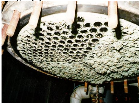
Gambar 2. 7 Fouling pada permukaan heat transfer shell and tube [2]
