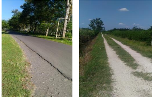
Gambar IV. 34 Kondisi Perkerasan Jalan di Desa Sidomekar Sumber : Survey Primer, 2018
