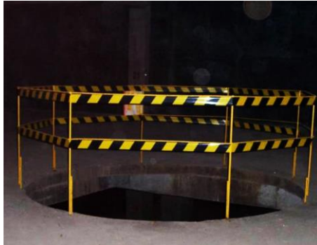
Gambar 5.17 : Contoh pemasangan safety railing pada lubang void struktur
