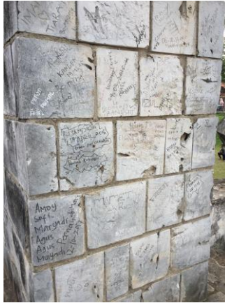
Gambar 4. 19 Kondisi Bangunan Cagar Budaya yang Mengalami Kerusakan
