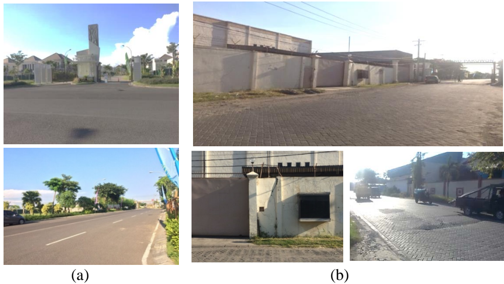
Gambar 4. 23 Kondisi Lapangan di Titik Grand Pakuwon; Lokasi Perumahan (a) dan Kerusakan Jalan di Area Sekitar (b)
