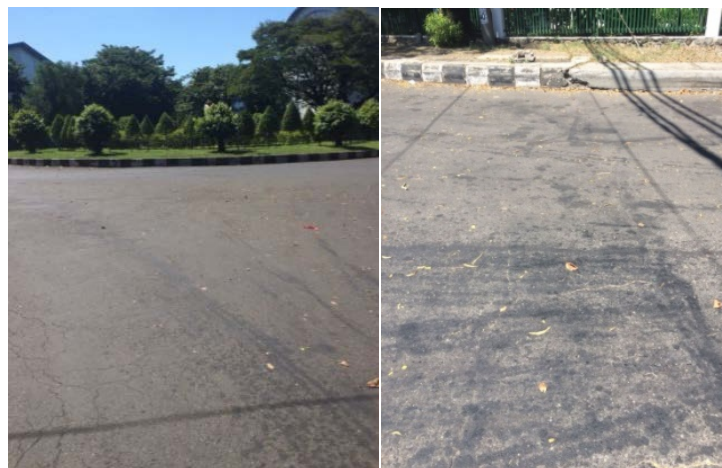
Gambar 4. 42 Kondisi Jalan dan Trotoar di Titik SIER
