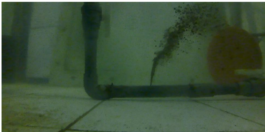
Gambar 5.3 Minyak yang keluar pada kebocoran ukuran 3 mm
