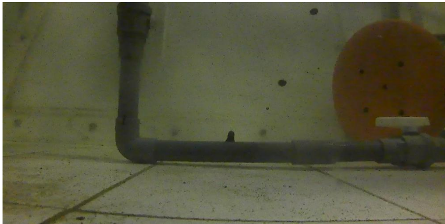
Gambar 5.1 Minyak yang keluar pada kebocoran ukuran 1 mm
