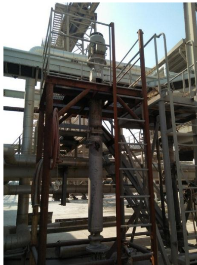
Gambar 4.3 Sistem pompa pada unit Sulphur Handling
