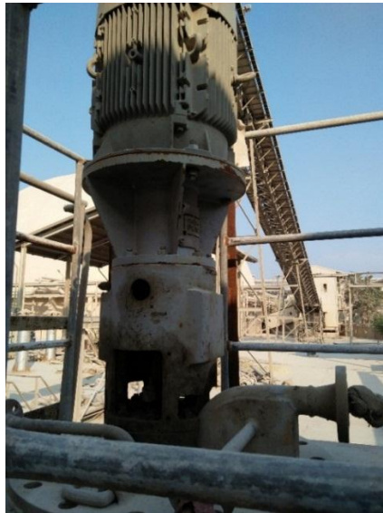
Gambar 4.8 Motor yang telah diangkat karena shaft patah
