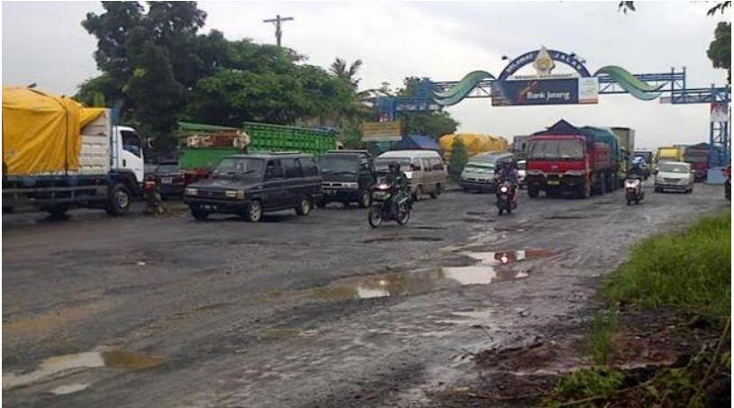
Gambar 4.2 Kondisi Jalan Jalur Pantura Kabupaten Kendal-Batang
