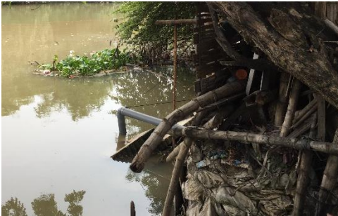
Pipa Pembuangan Limbah Domestik Ke Sungai
