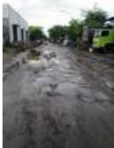
Gambar 1.3 Perkerasan Berlubang dan Tergenang Air
