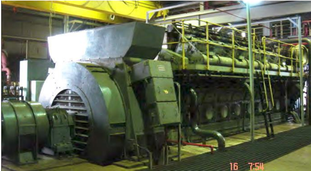
Gambar 2. 4 Pembangkit Listrik Tenaga Diesel (PT Vale PLTD)
