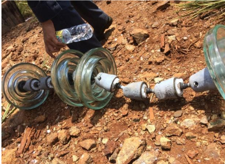
Gambar 3.2 Kegagalan yang khas terjadi pada pin insulator 150 kV akibat sambaran petir (gambar diambil pada tower KR#7B)
