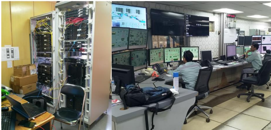
Gambar 3.2 Thermal Control room dan Soroako SCADA server room .
