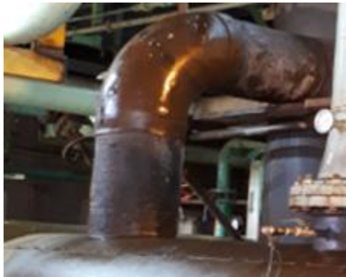
Gambar 3. 7 Pipa uap air pada bagian air dryer PT. Vale Indonesia
