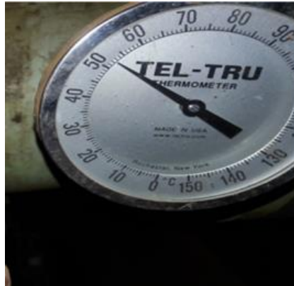
Gambar 3. 10 Temperatur gauge pada air dryer
