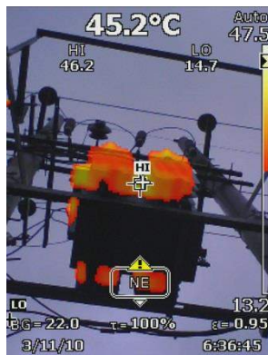
Gambar 4. 35 Foto inframerah transformator menggunakan FLUKE Ti125 bentuk bitmap
