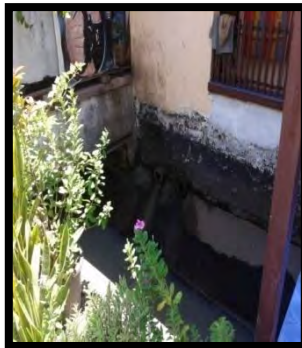
Gambar 3.5 Kondisi saluran drainase di wilayah perencanaan Kelurahan Kapasan
