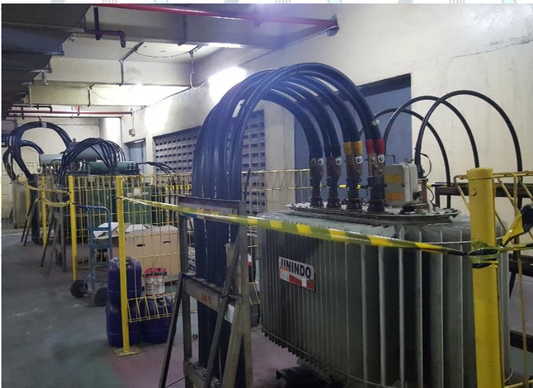
Gambar Trafo Pada Kantor Pertamina Pusat Jakarta
