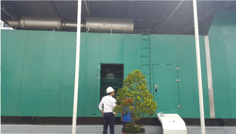
Gambar Genset (2000 kVA) Pada kantor Pertamina Pusat Jakarta
