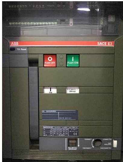
Gambar 2.7 Air Circuit Breaker PT. Surya Pamenang Kediri
