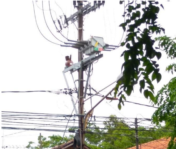
Gambar 2.1 Load Break Switch di lingkungan kerja UP2D
