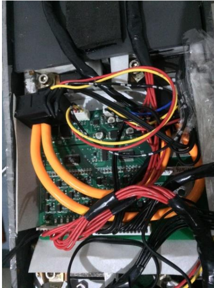
Gambar 4.29 Pengamatan kondisi fisik dan koneksi elektrik BMS
