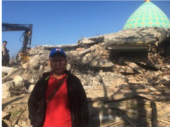
Gambar 1. 3 Salah satu masjid di Lombok akibat dari gempa Lombok (Dokumen pribadi Helmy Darjanto)
