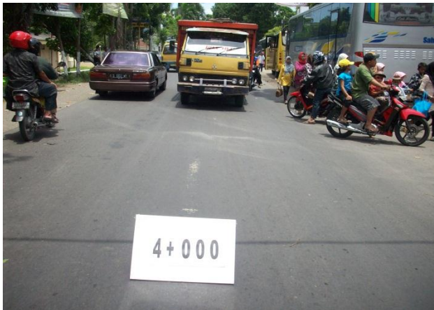
Gambar 1.5 Ruas Jalan pada STA 4 + 000
