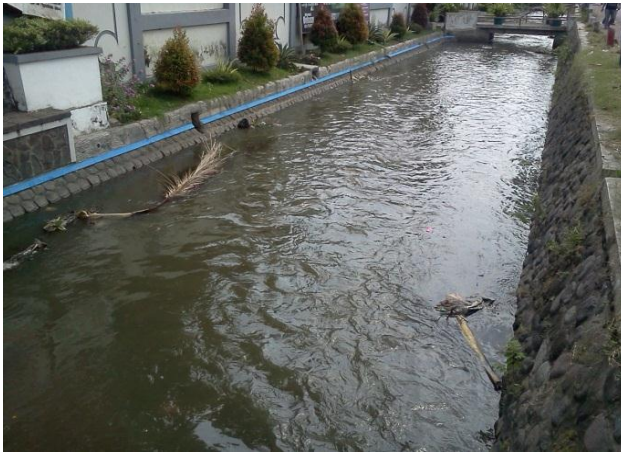
Gambar 1.7 Saluran Pembuangan pada STA 3 + 900
