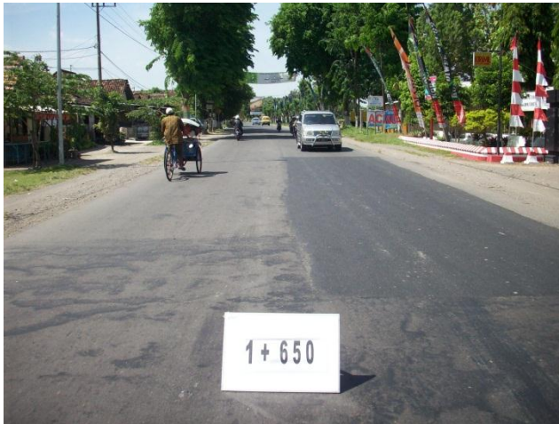
Gambar 1.4 Ruas Jalan pada STA 1 + 650
