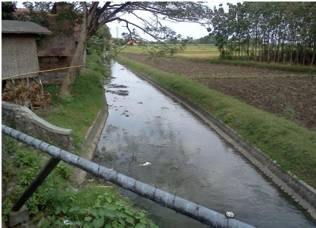
Gambar 1.4 Saluran Pembuangan pada STA 1 + 950
