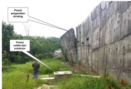
Gambar 1. 7 Area dinding yang mengalami pergerakan (Sumber : GEC 2018, Report ReviewGrand blpp)
