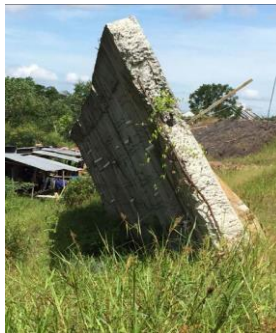
Gambar 4. 6 Kondisi eksisting dinding penahan tanah pada daerah yang longsor (Potongan A STA +0.065) (Sumber : GEC 2018, Report Review Grand blpp)
