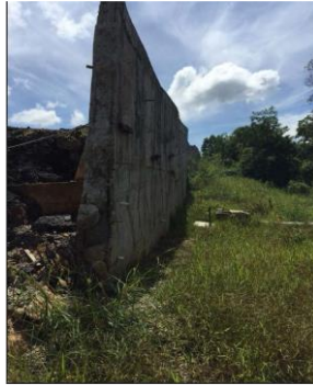
Gambar 4. 7 Kondisi eksisting dinding penahan tanah yang relatif terlihat tegak (Potongan A STA +0.090) (Sumber : GEC 2018, Report Review Grand blpp)
