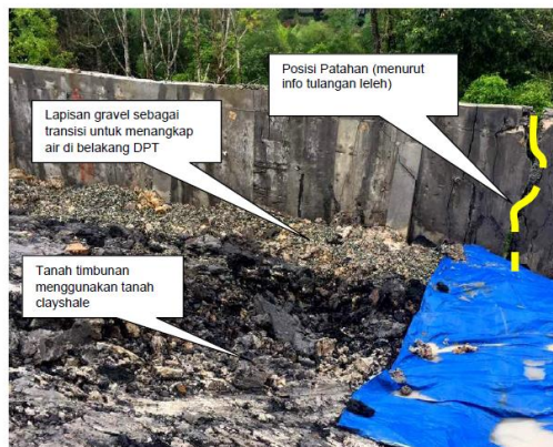
Gambar 1. 6 Kondisi sekitar DPT yang mengalami patah (Sumber : GEC 2018, Report ReviewGrand blpp)
