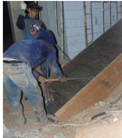
Sumber : PT. Brantas Abipraya Gambar 4.55 Contoh beton disebarkan dari atas tangga ke bawah
