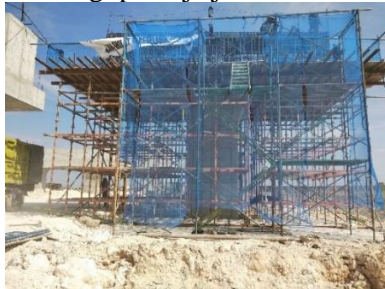
Gambar 2. 37 Safety Net Sumber: Dokumentasi pribadi
