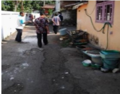
Gambar 2. 7 Kondisi Permukaan Jalan Lingkungan yang Rusak
