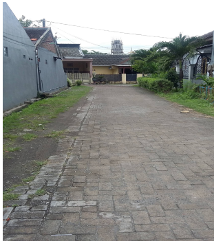
Gambar L5. 13 Permukaan Jalan yang Bergelombang di RT 32
