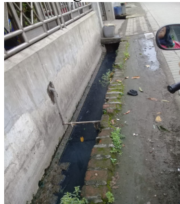
Gambar L5. 7 Drainase Tidak Dapat Mengalir di RT 24
