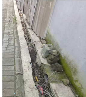
Gambar L5. 5 Drainase Tidak Berfungsi di RT 01
