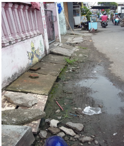
Gambar L5. 6 Kondisi Drainase di RT 08
