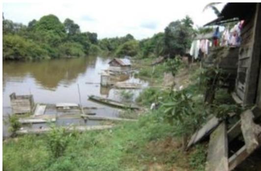
Gambar 2. 13 Pengelolaan Air Limbah Tidak Sesuai (Menteri Pekerjaan Umum dan Perumahan Rakyat Republik Indonesia 2016)
