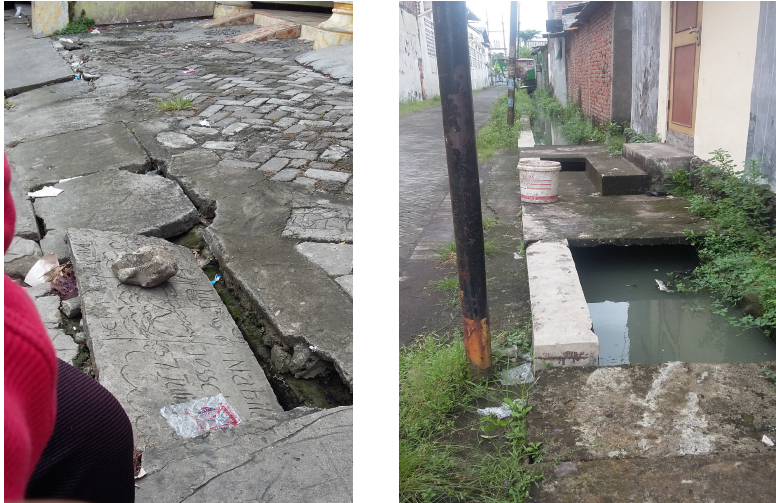
Gambar 4. 4 Kerusakan pada penutup saluran drainase
