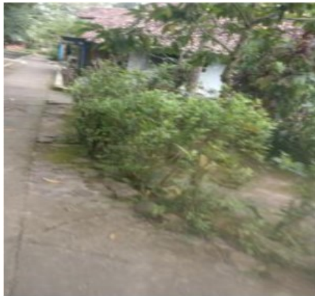
Gambar 2. 9 Kondisi Jalan yang Tidak Dilengkapi Saluran Drainase (Menteri Pekerjaan Umum dan Perumahan Rakyat Republik Indonesia 2016)
