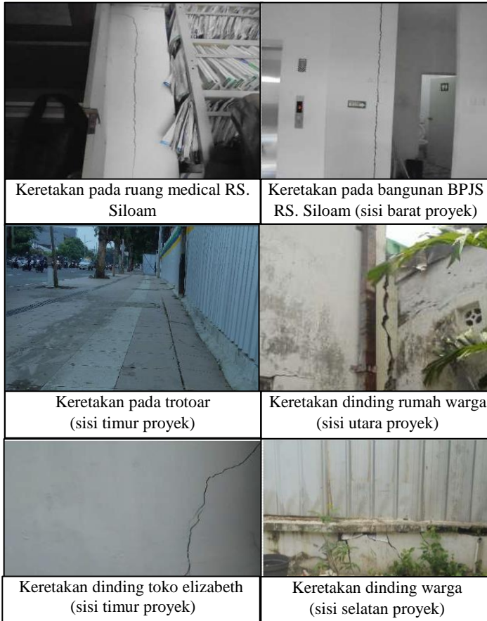
Gambar 1. 4 Gambar keretakan-keretakan pada bangunan sekitar proyek “ Gubeng Mixed-Use Development ”
