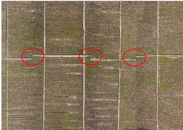
Gambar 4. 12 Objek jalan diperkebunan kelapa sawit yang masih terdapat pergeseran
