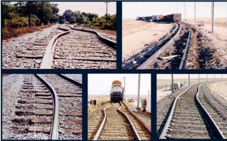
Gambar 2. 13 Contoh Track yang Mengalami Buckling [14]
