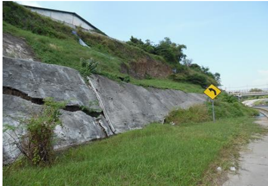
Gambar 4.2 Keretakan pada shotcrete (Sumber: PT Jasa Marga)
